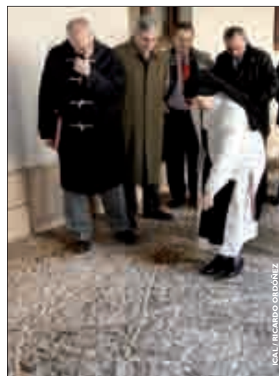
Los representantes de la Fundación observan el estado del suelo del claustro.
