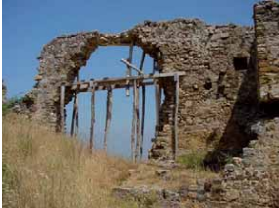
Ventanal apuntalado antes de realizar la intervención.
